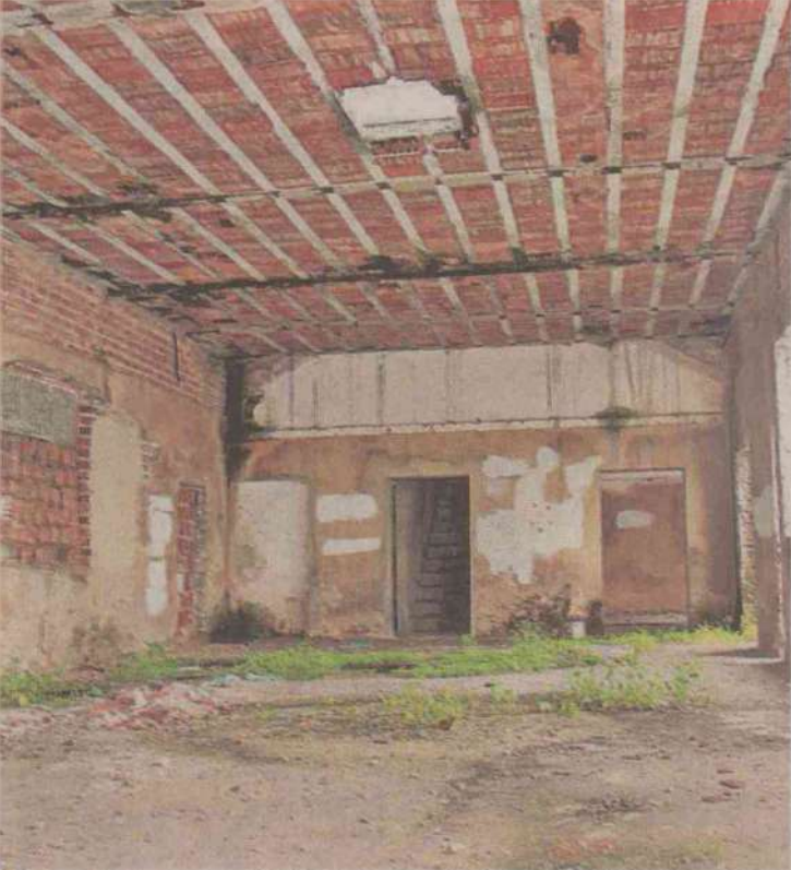
Duas edificações estão completamente deterioradas
