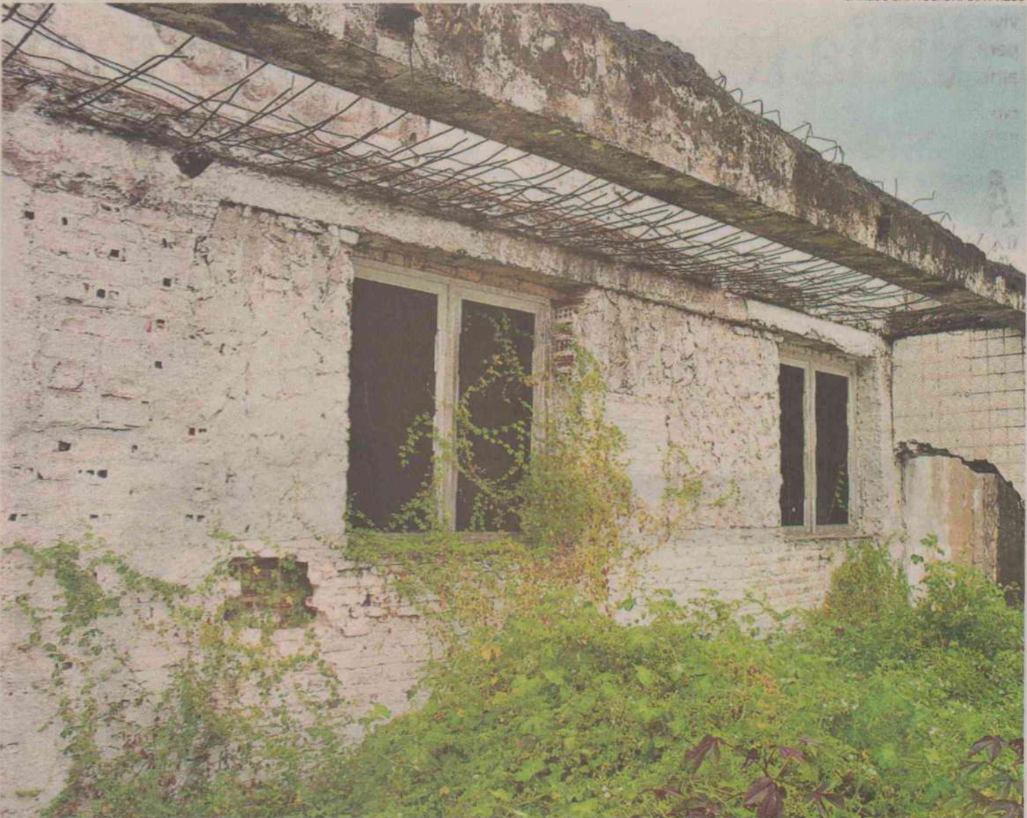
Com construções relegadas à falta de manutenção, sítio histórico deve ter licitação de obras iniciada no 2º semestre
