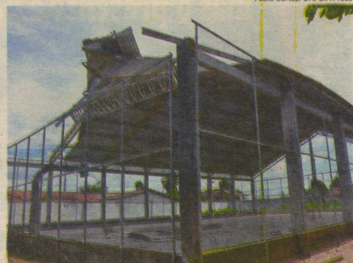
Quadra de esportes, cujo teto ameaça desabar, já começou a ser isolada
